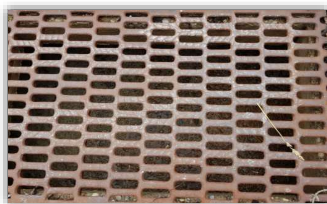
Abb. 56: Foto der Abdeckung des Güllelochs bei einem am Projekt beteiligten Landwirt
